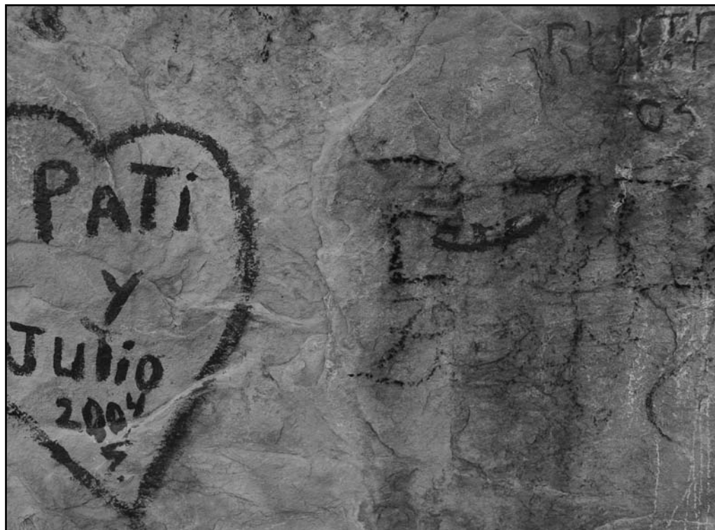
Fig. 3 Ejemplo de vandalismo en el sitio de Lajasmayu 2. Foto SIARB, marzo de 2008.
